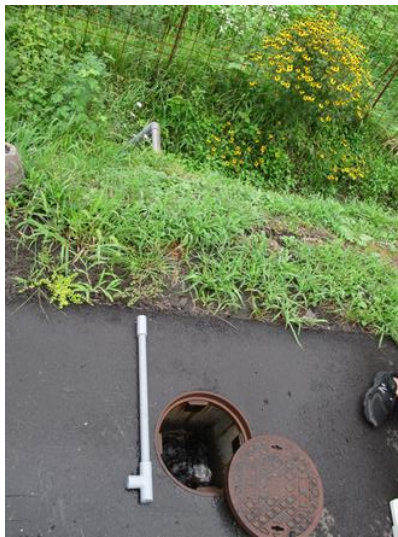
写真2 n 浄水場配水区域末端に設置されている排流装置
