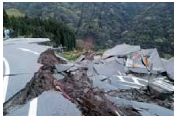
道路の損壊（南阿蘇村）
