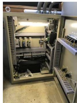
遠隔監視制御盤（内面）
