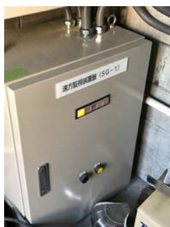
遠方監視装置盤
