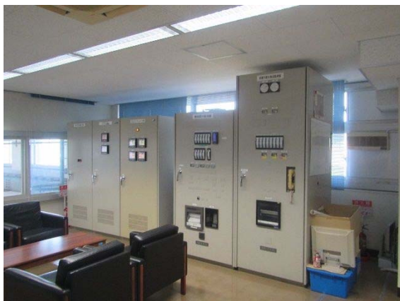
① テレメーター盤 (F社・Mw社 専用回線) : Nd 浄水場
