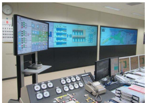
② 自動水質測定装置監視モニター (Mt社) : Fg浄水場
