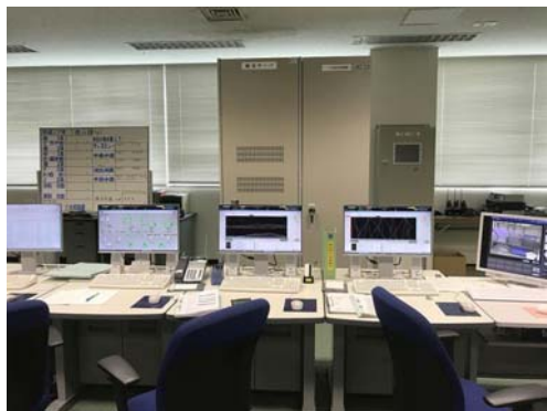
中央監視システム
