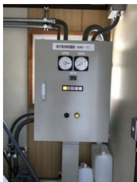
遠方監視装置盤
