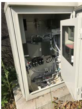
自動水質監視装置
