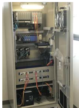
遠隔監視制御盤
