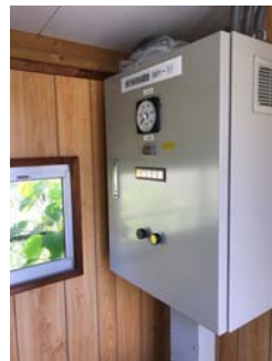
遠隔監視装置盤 (送水流量)
