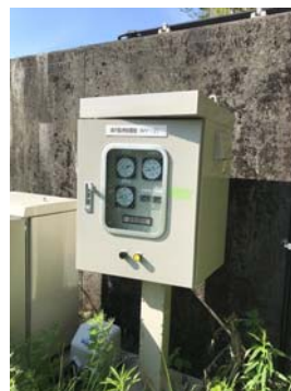
遠隔監視制御盤 (配水池水位、流量)
