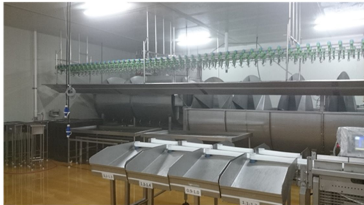
写真2-4 チラー槽およびと体解体室
