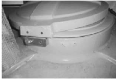
FRP製パネルタンク。 スロッシング水圧によって、マン ホールハッチ部が破損。 修理すれば、使用可能。
