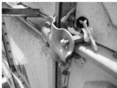
FRP製タンク(108t)。 スロッシング水圧によって、上段側 板パネルが破損。 修理すれば、使用可能。
