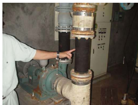
フレキシブルジョイントの亀裂
