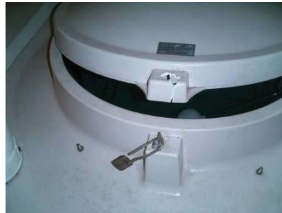
マンホール施錠部の破損
