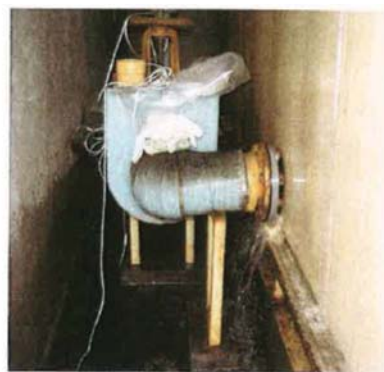
震災被害による漏水の一例
