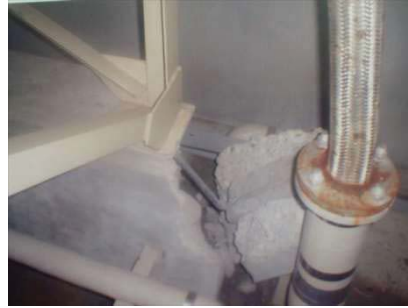
基礎土台崩壊
