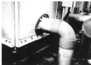
溢水口の破損（サポート無し）
