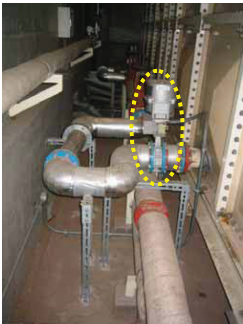
市の補助金を活用し受水槽に緊急遮断弁を設置したマンション実例（浦安市・築25年・1100世帯）
