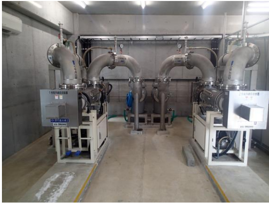
紫外線処理設備
