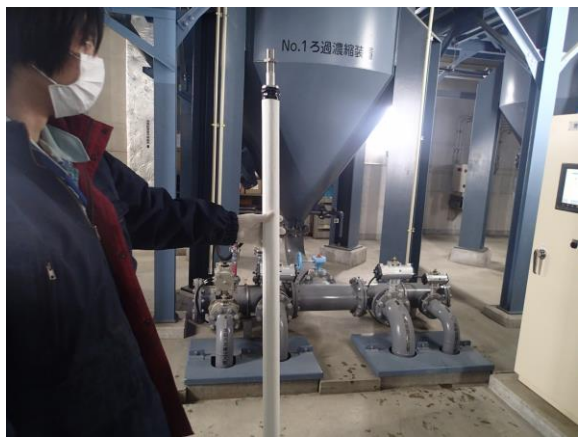
汚泥処理施設②（ろ過濃縮機フィルター）
