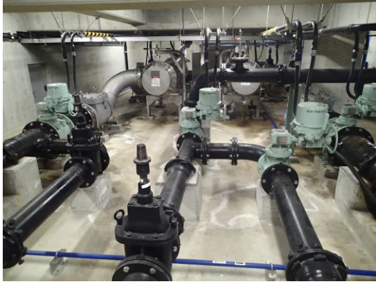
紫外線処理設備（1）
