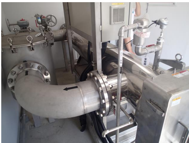
紫外線処理設備（2）
