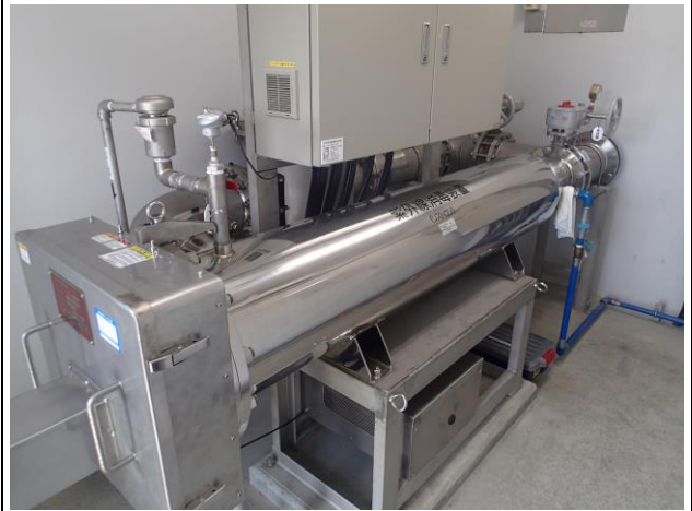
紫外線処理設備（1）
