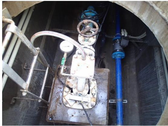
⑨Rd 浄水場（井戸マンホール）
