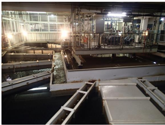
高速凝集沈澱池①
