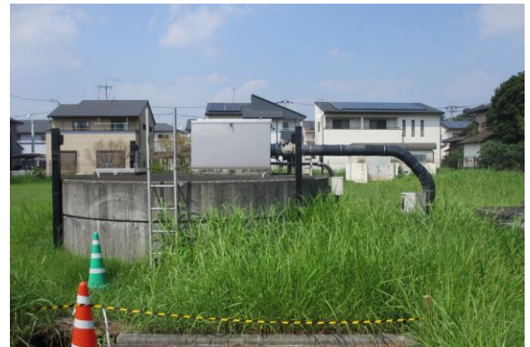
付近が陥没した浅井戸1号井
