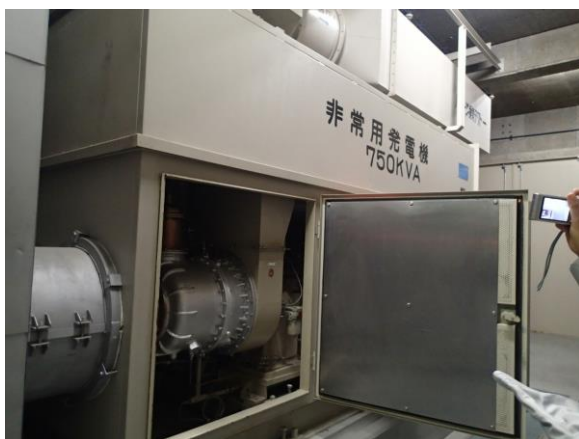
導水ポンプ場（非常用発電機）
