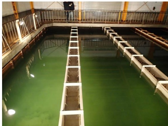
高速凝集沈澱池④（傾斜管なし）
