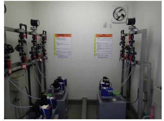
⑩Rd 浄水場（薬注室：PAC 及び次亜）
