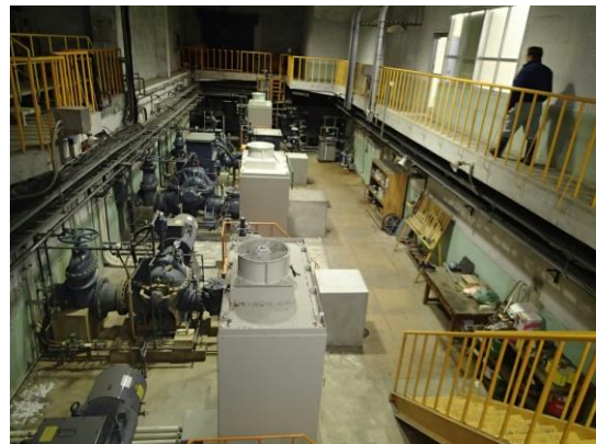
導水ポンプ、導水管は2条
