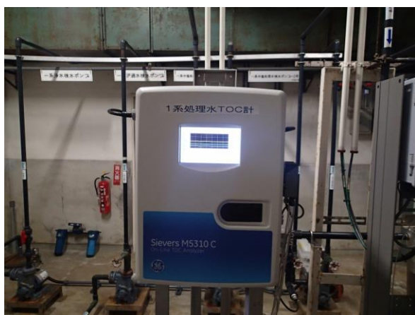
沈澱処理水 TOC 計
