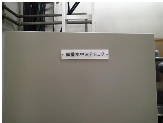
導水ポンプ場内：油分モニタ
