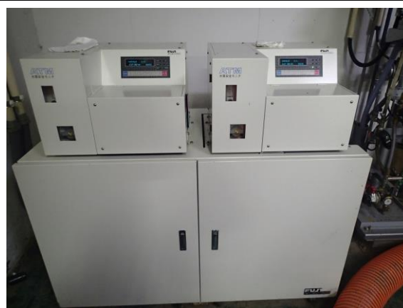
ポンプ場内：水質安全モニタ（バイオセンサ）
