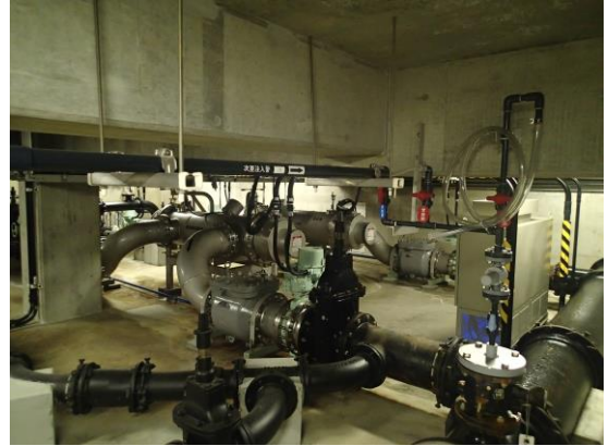
紫外線処理設備（2）
