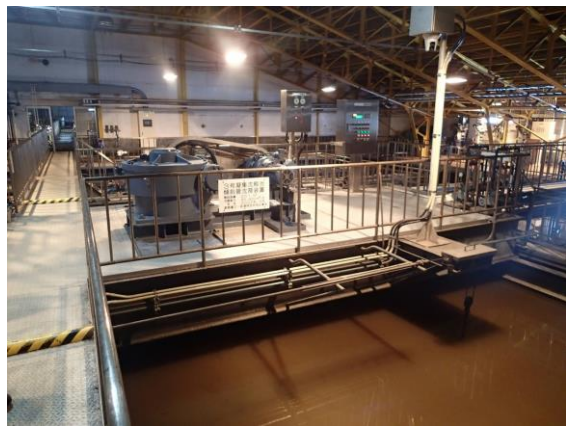
高速凝集沈澱池②
