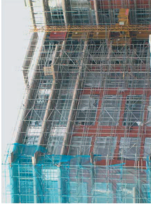
イギリス(バーミンガム)の足場の例 作業床のないところには手すり、幅木等は付けない
