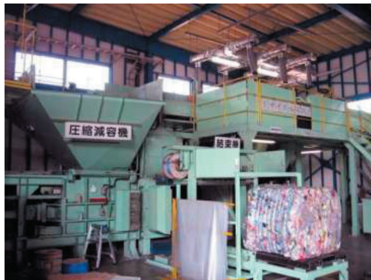
写真3 事故が発生したペットボトルプレス機
