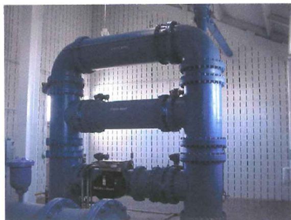
図 4.25 オハイオ州レバノンの Deerfield-Hamilton 水処理プラントでろ過した地下水 12 MGD (45,000m 3 /日) を処理するために使用されている TrojanUVSwift™24
