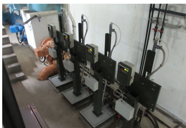
急速ろ過水用濁度計
