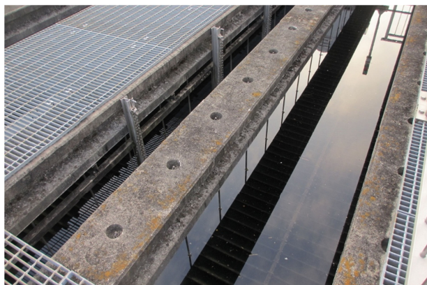
傾斜板沈澱池
