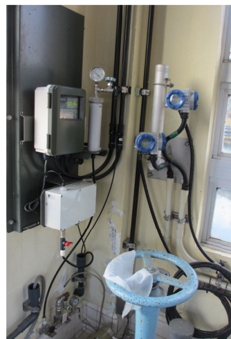
緩速ろ過水用濁度計及び損失水頭計
