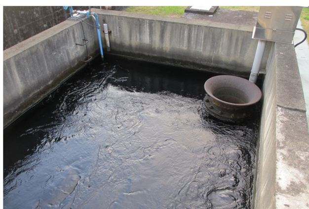
ろ過池着水井
