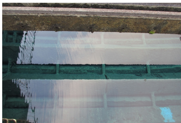
高速凝集沈澱池（抜水中）
