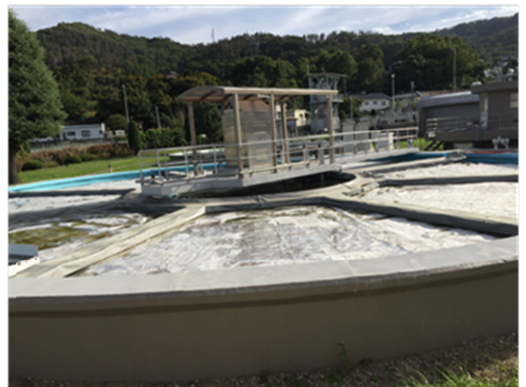
高速凝集沈澱池 (1)
