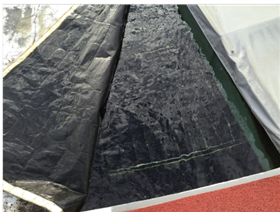
高速凝集沈澱池 (2)
