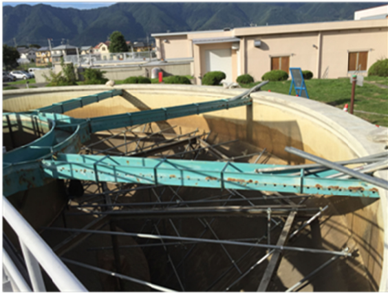
高速凝集沈澱池（4）
