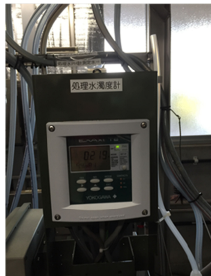
処理水濁度計
