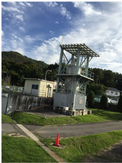
活性炭貯蔵設備
