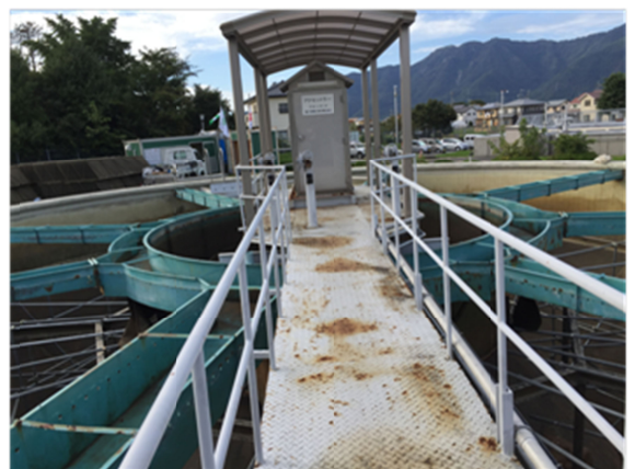
高速凝集沈澱池 (3)
