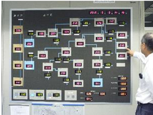
グラフィックパネル盤
