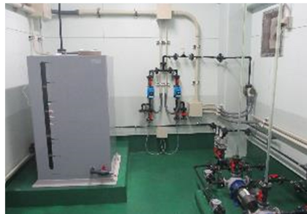
残塩注入設備
