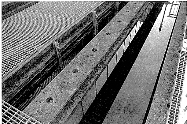
傾斜板沈澱池
