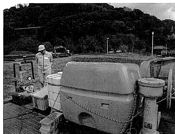
写真-3 : 仮設活性炭注入設備と着水井
