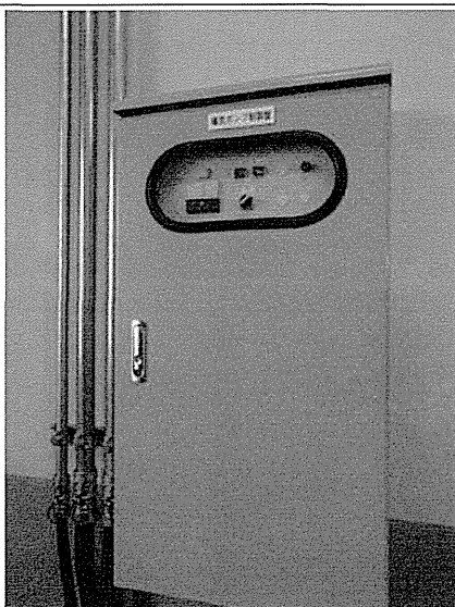
曝气处理 (ポンプ盤)
