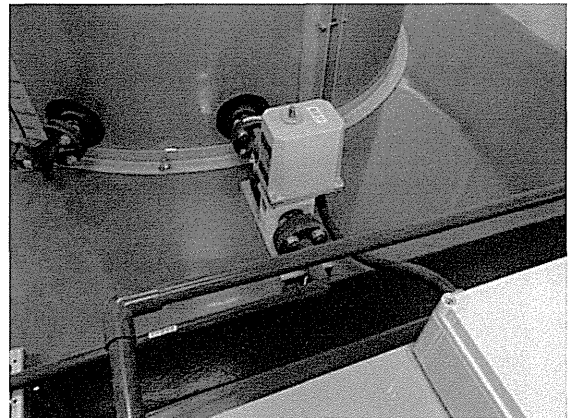
薬品タンク電動弁 (漏出防止)
