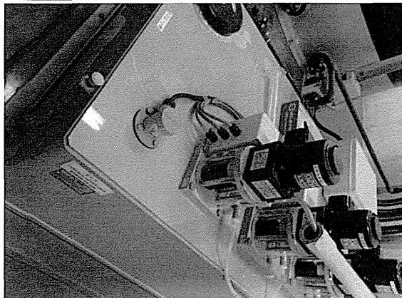
薬品タンク小 (次亜塩素)
