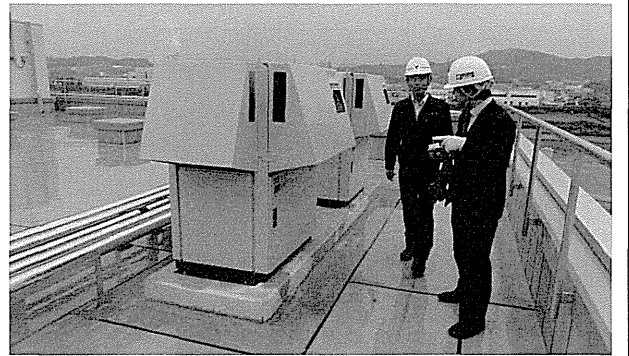
次亜温度管理用チラー（建屋屋上）
