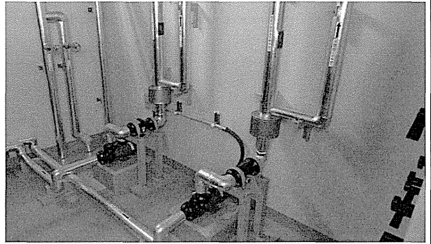
次亜循環ポンプ
