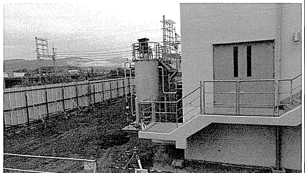
ろ過池排水の上澄水ろ過機（屋外）
