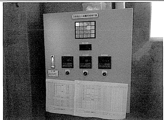
次亜塩素注入装置操作盤
