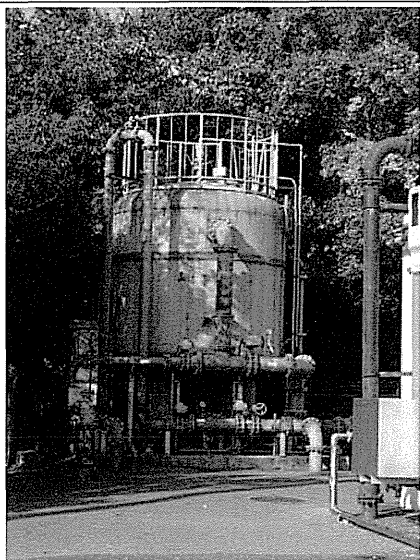
深井戸除鉄除マンガン装置
