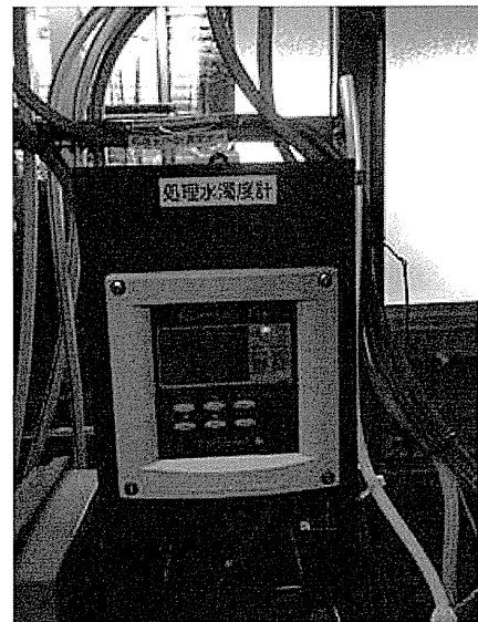
処理水濁度計
