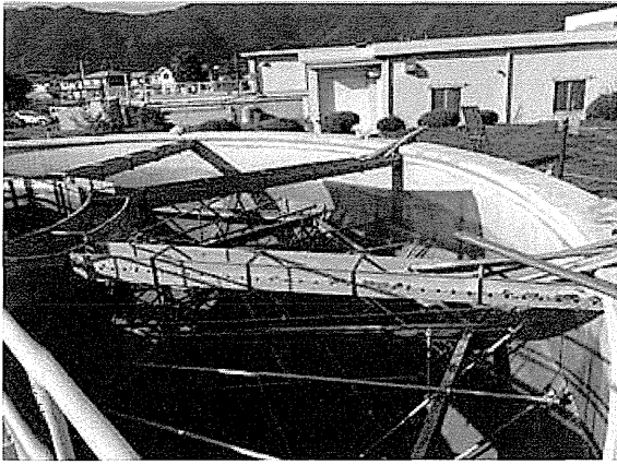
高速凝集沈澱池 (4)
