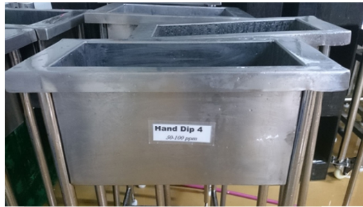
写真2-6 グローブが汚れた時に 浸す消毒槽(塩素濃度100ppm)
