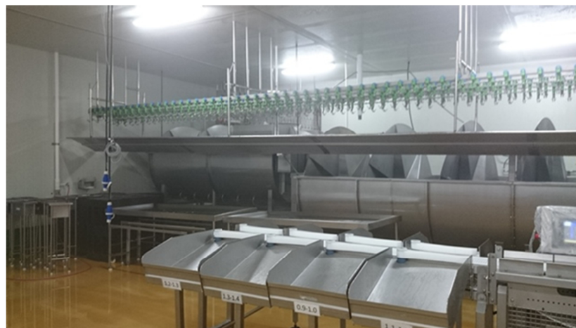
写真2-5 チラー槽およびと体解体室
