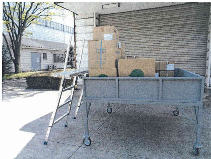
土台となるステップ2台を設置し足場板を設置した状態
