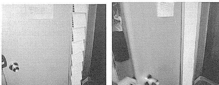
図9-2 ガラリの内側にダンパーとして設置された短冊状の紙の動き 換気扇で発生した陰圧により持ち上げられメーカーアップ・エアが流入し、ドアを喫煙室側に開くと陰圧が弱くなりダンパーは閉じる
