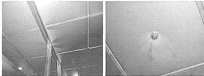
図11 天井とパネル (左)、スプリンクラー (右) の隙間から空気が流入するために発生したヤニの着色ムラ
