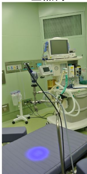
天井灯 全点灯
