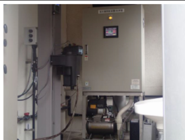
濁度計（手前）と紫外線処理装置制御盤（下部に結露の発生を防止するコンプレッサー）
