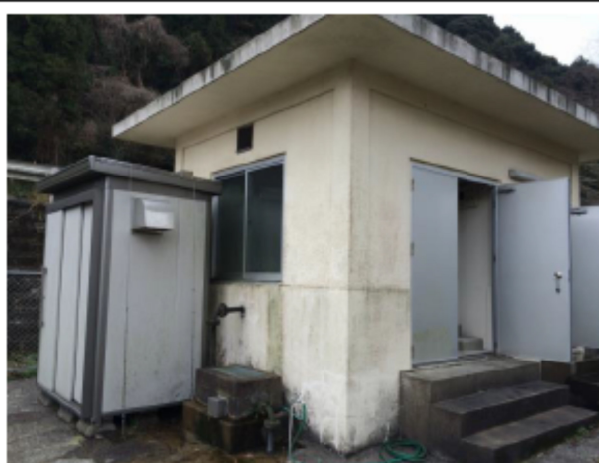
次亜注入機設備（左）は、建屋の外に設置
