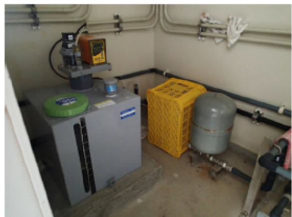
次亜注入機室（ドアを隔てた場所）
