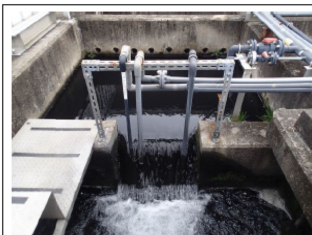
薬品注入点（PAC）
