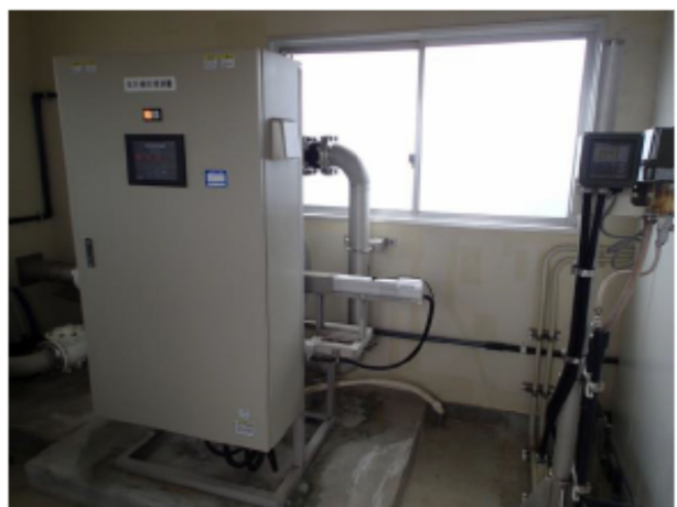
紫外線処理装置（盤の後ろにある）
