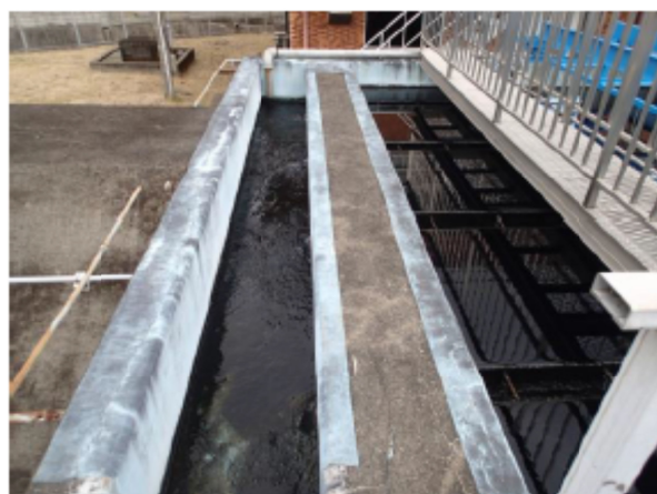
沈澱池流出渠（中次亜注入点）
