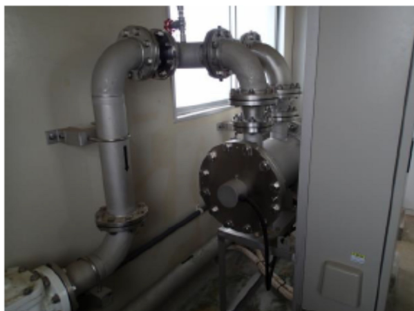
流入管（下部）、流出管（上部）
