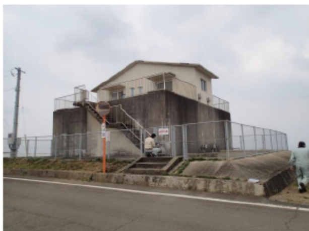
配水池の上に紫外線処理建屋
