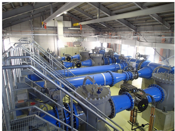
紫外線処理設備（1）
