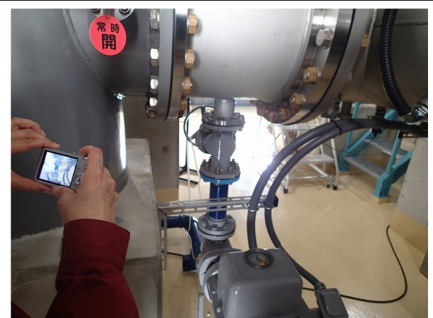
ランプ点灯したまま処理停止中の循環水用配管
