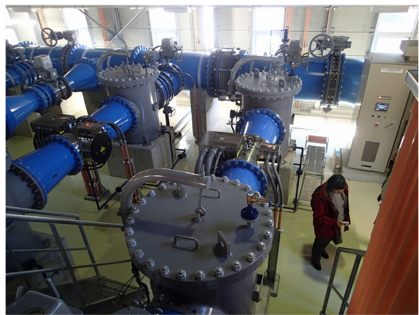
紫外線処理設備（2）
