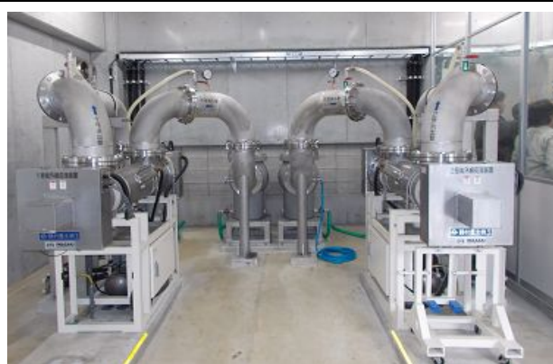
紫外線処理設備 2 台の全景。中央が流入管、右手奥に操作盤がある。手前架台上の黄色テープはランプ引出し時のスペースエリアを示している。
