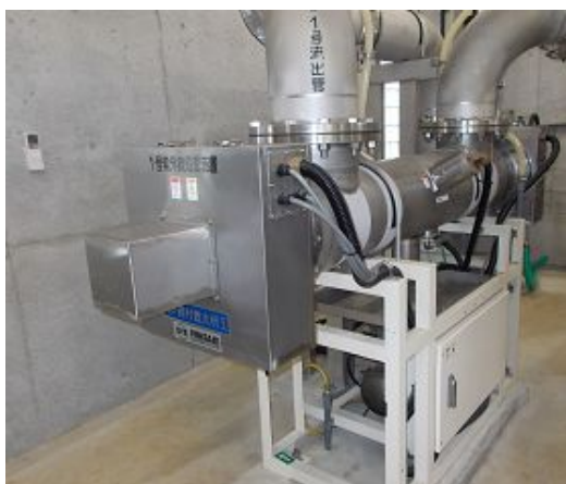
UV 装置 (除湿用エアコンも後付で設置)
