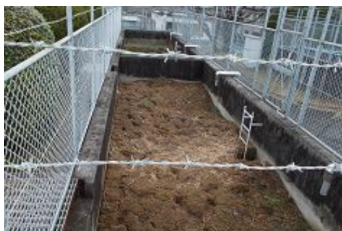
天日乾燥床。汚泥はあまり溜まらないので、2、3年に1回処分している。
