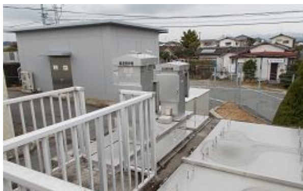
汚泥処理設備(手前)と後方に電気設備の建屋。市内で唯一凝集剤(PAC)を使用している場所。
