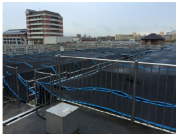
傾斜板式沈澱池
