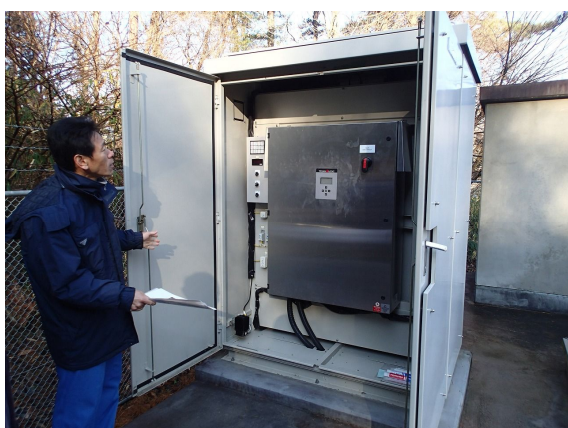
UV装置制御盤
