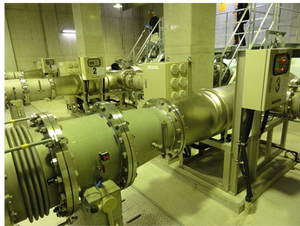
3 台の紫外線処理設備
