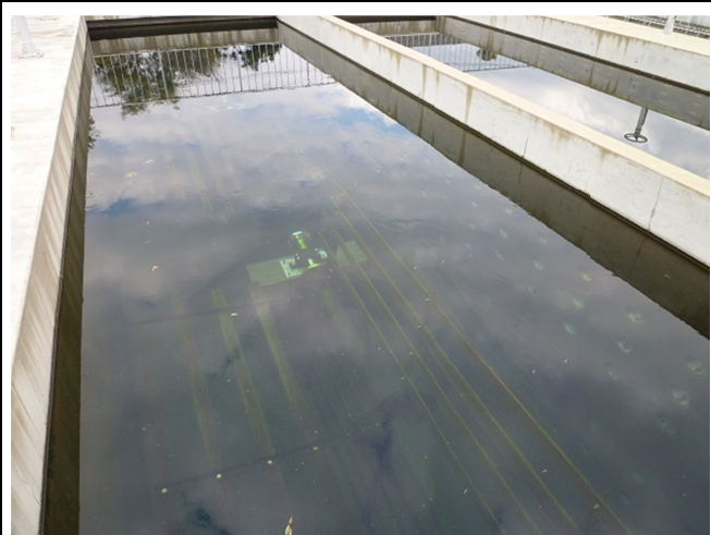
フロック形成池（この日は凝集剤注入なし）
