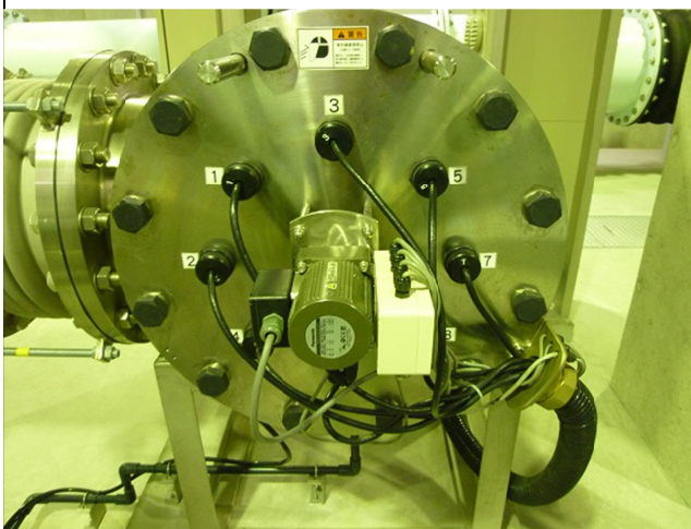
ランプ挿入部(8 本/機)
