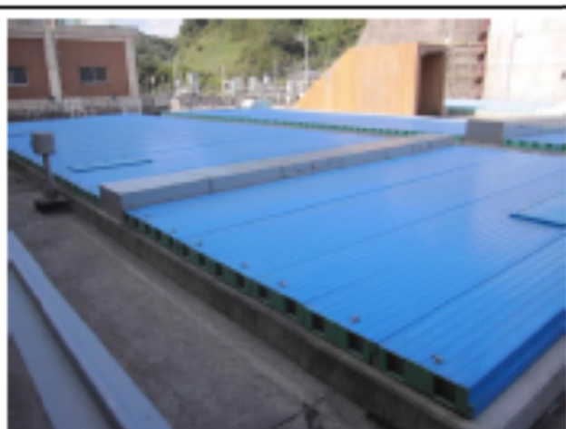
沈殿池の覆蓋
