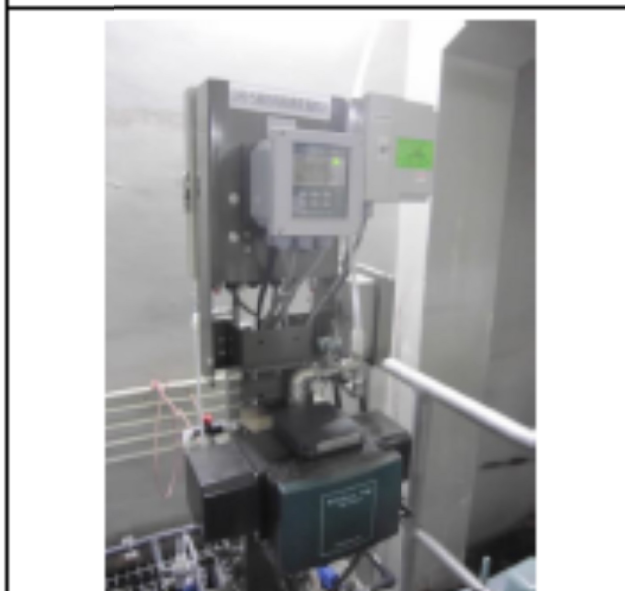
ろ過水高感度濁度計 (横河製)
