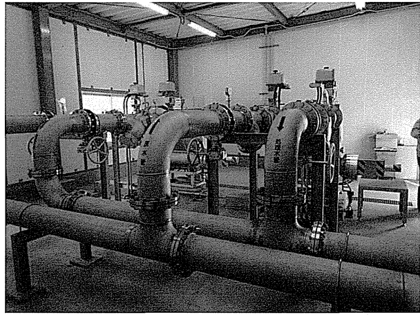
紫外線処理装置全体（反対側から撮影）
