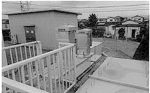
汚泥処理設備(手前)と後方に電気設備の建屋。 市内で唯一凝集剤(PAC)を使用している場所。
