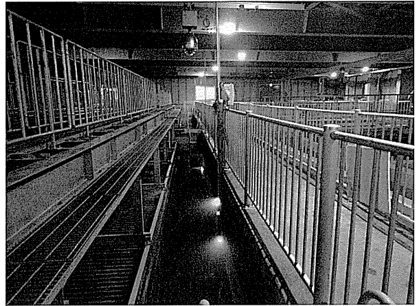
沈澱池とフロック監視カメラ
