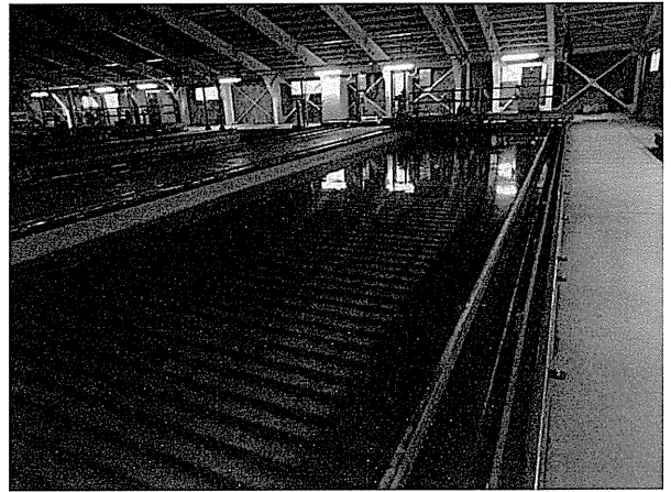
ろ過池 (ハーディングフィルター)
