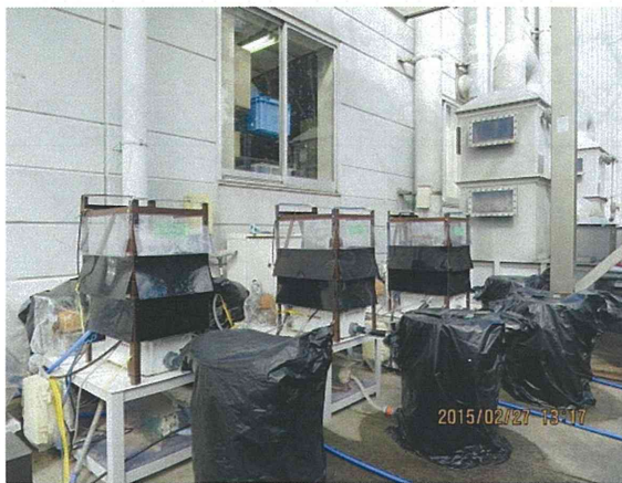
図2. モデル冷却塔の設置状況
