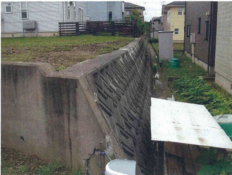
宅地の被害（擁壁の変動）
