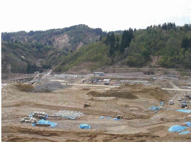
寺野地区災害復旧工事の様子 (河道閉塞後の対策工事) (2006年5月12日 伊藤和也撮影)
