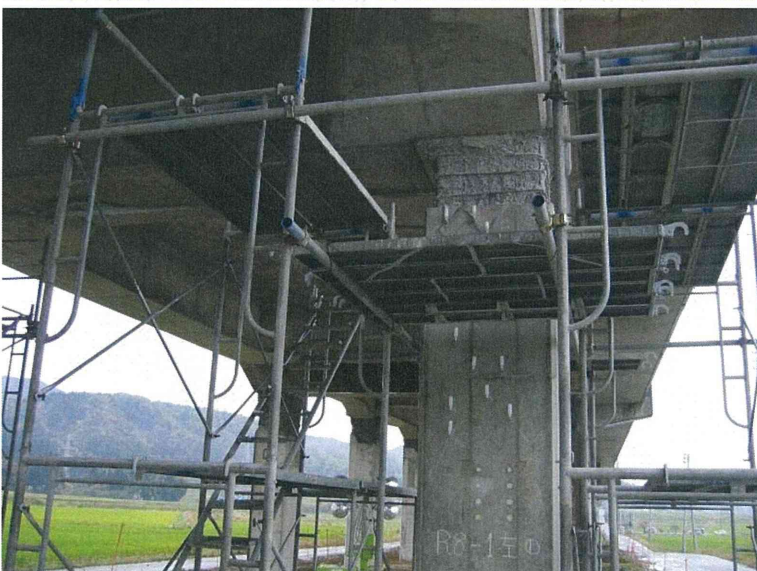
脱線した上越新幹線の橋脚。既に橋脚の補修工事が始まっていた。
