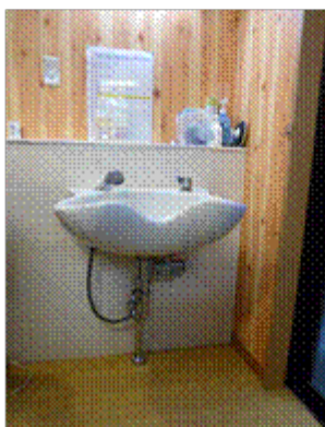
写真5 脱衣室に設置された洗髪洗面器
