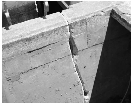
図 39 地盤液状化に伴う不同沈下による沈澱池側壁のクラック（蛇田浄水場）
