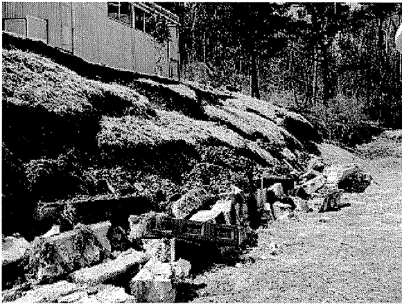
ろ過池下流側のブロック積擁壁の崩壊
