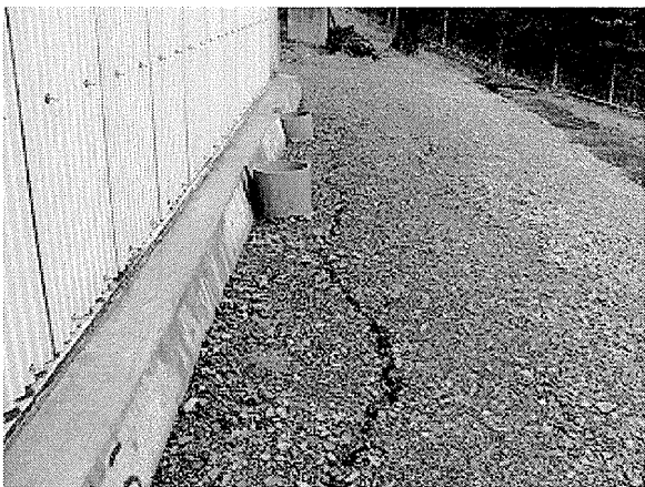
写真3 土嚢土留め上部の亀裂
