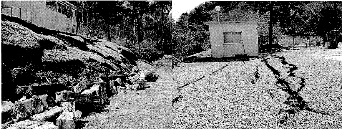
ろ過池下流側のブロック積擁壁の崩壊
