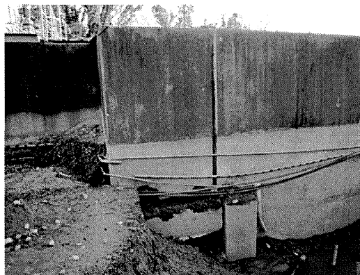
図 40 地盤液状化に伴う沈澱池目地の開き（新宿浄水場）
