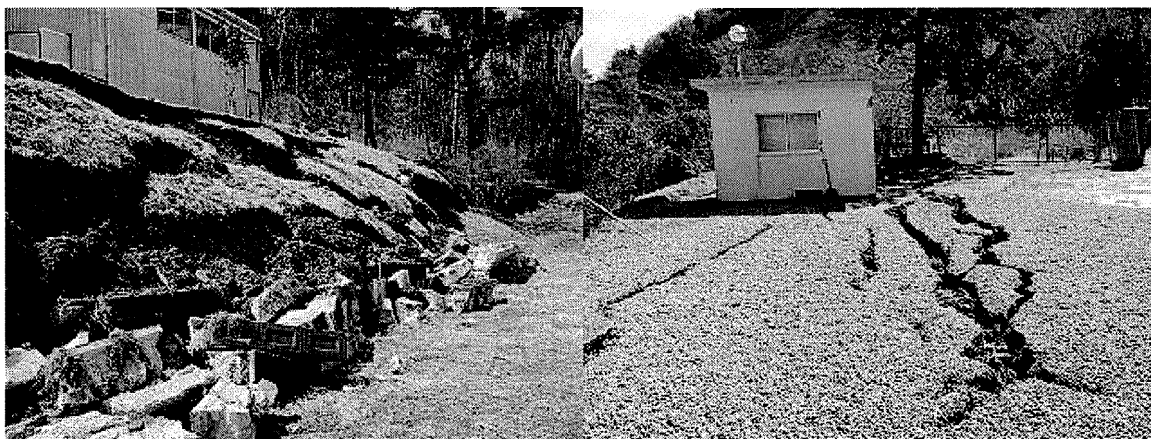
ろ過池下流側のブロック積擁壁の崩壊
