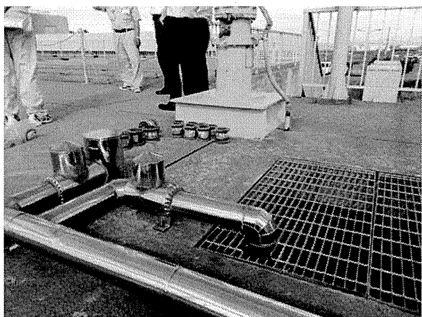
(3) PAC注入点、急速攪拌池
