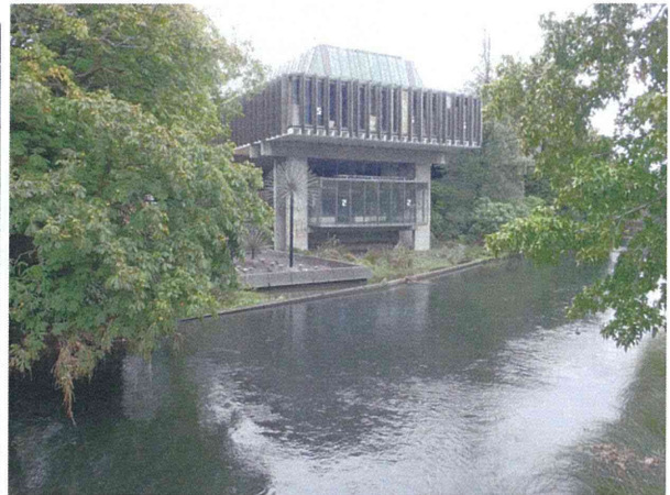
エイボン川岸壁が沈下している
