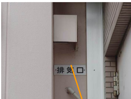
屋外放出口の設置場所
