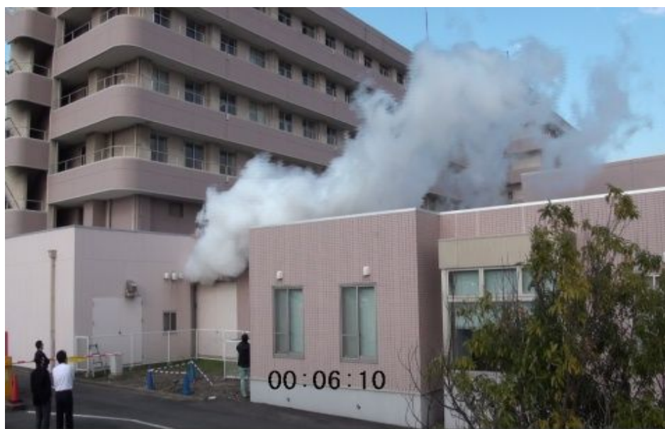
00:06:10 クエンチ発生約 15 秒後 既に白煙は建屋上にまで広がっている。
