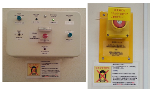
図7 実際の使用例 異なるデザインのクエンチボタンであるが、統一シールを掲示することによりボタンの機能が明確になる。
