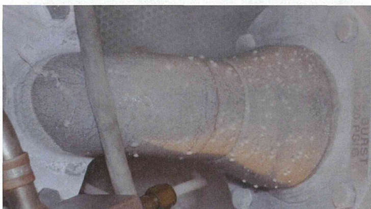
メイン放出配管
