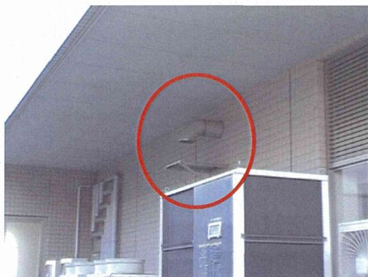
クエンチ前の屋外放出口 00:15
