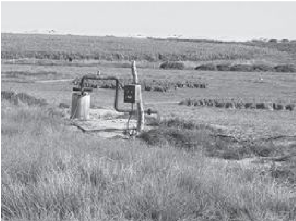
地下水くみ上げ設備
