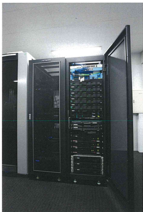
図 プロジェクト専用サーバー
