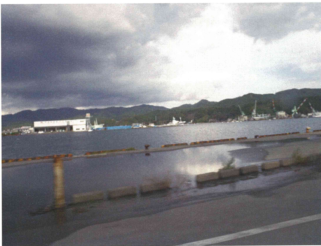
全域での地盤沈下（沈降）により満潮時に海水が流入する護岸
