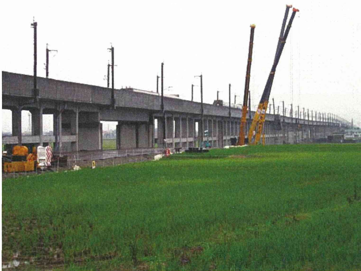
脱線した上越新幹線。既に大半の撤去作業は終了していた。
