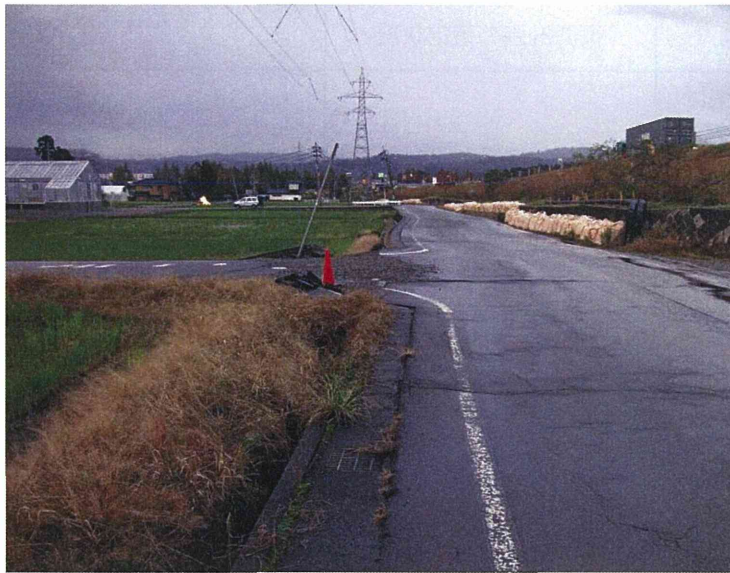
右側が関越道（小千谷 IC 付近）。盛土がすべり変形している。
