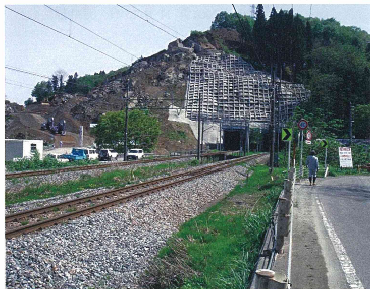
復旧作業が進む県道（左）（長岡市妙見町）
