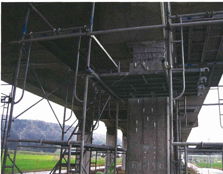
脱線した上越新幹線の橋脚。既に橋脚の補修工事が始まっていた。
