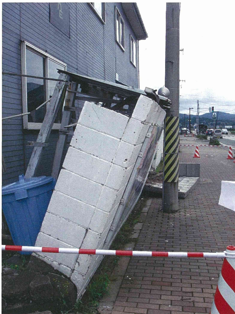
柏崎市の旧砂丘地域の液状化による側方流動による変動
