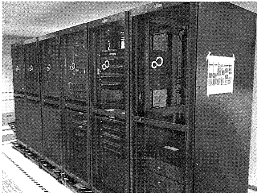
図 22 クラウドサーバーの設置風景
