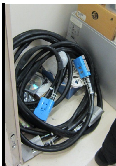
電源接続用ケーブル
